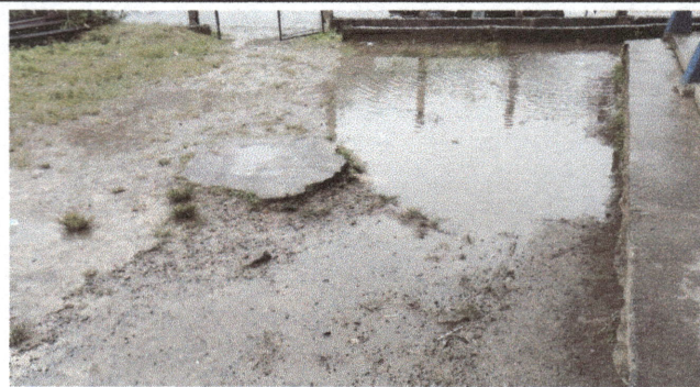
Foto 2: Losa de patio quebrada que pone en riesgo la integridad de los niños.
