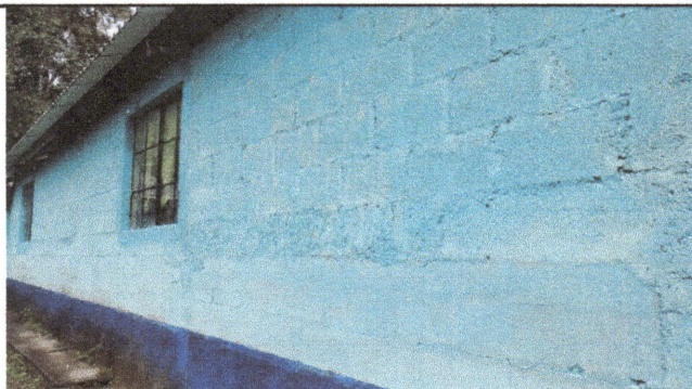
Foto 7: Las paredes exteriores de aulas en mal estado, que necesita repello y pintura (módulo 1 de 5 X 14 Metros)
