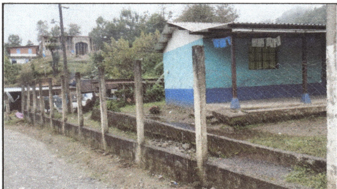
Foto 3: Muro perimetral: con el paso de los años se ha deteriorado el material, y los postes necesitan refuerzo.
