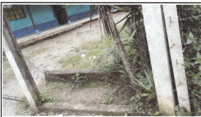
Foto 4: Malla del muro perimetral en pésimas condiciones, que necesitan ser sustituido.
